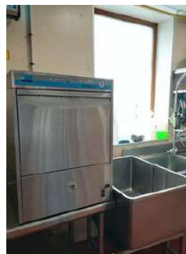
Plonge et bac de trempage
